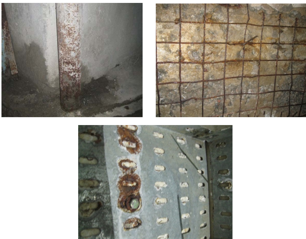
Рисунок – Поврежденные поверхности железобетонных конструкций
